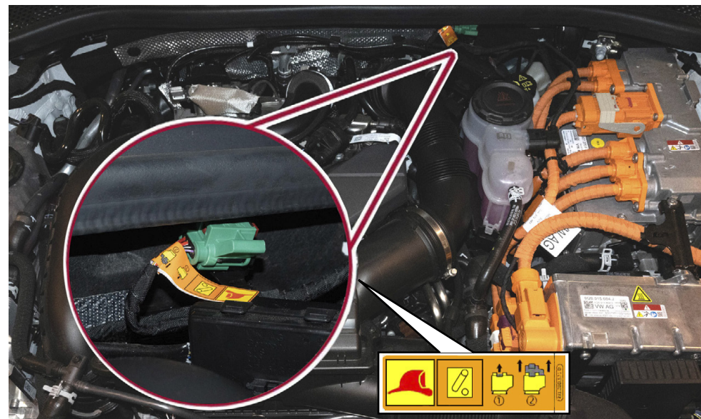
Disjunctor în compartimentul motor al autovehiculelor hibrid. Consultați și „Identificarea anterioară” .
